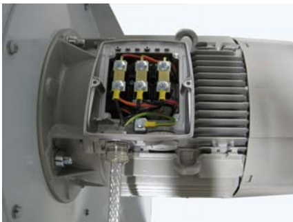
Figure 3.15 Fan motor wiring
