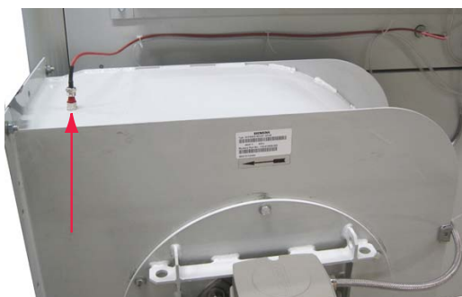
Figuur 3.21 PT1000-aansluiting bij regeneratieventilator
