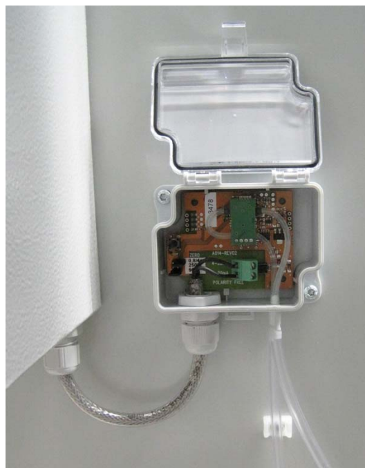
Figuur 3.23 Aansluiting DPT (procesluchtventilator)
