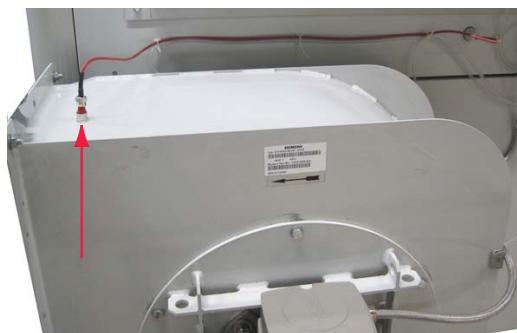
Рисунок 3.21 Подключение датчика РТ1000 на вентиляторе воздуха реактивации
