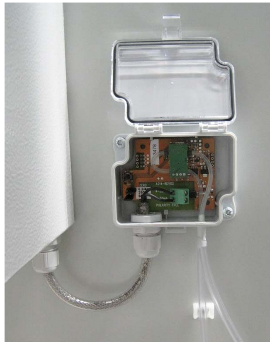
Abb 3.23 Anschluss für Differenzdruck-Messumformer (Prozessventilator)
