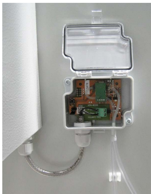
Figuur 3.23 Aansluiting DPT (procesluchtventilator)
