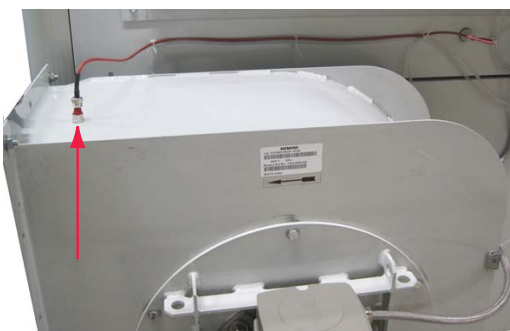
Figuur 3.21 PT1000-aansluiting bij regeneratieventilator
